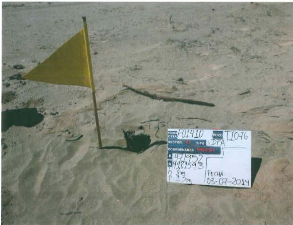
Fotografía N° 1. Se observa el casing del Pozo T1076 en avanzado estado de corrosión abierto y expuesto al ambiente.
