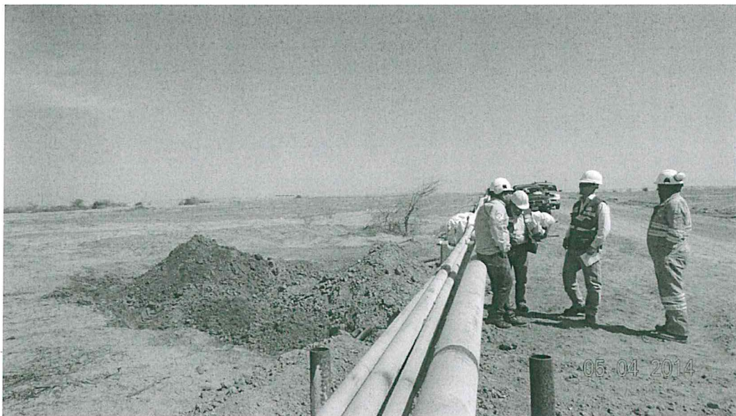
Fotografía N° 1. Área del derrame de hidrocarburos de tuberías sustraídas.
