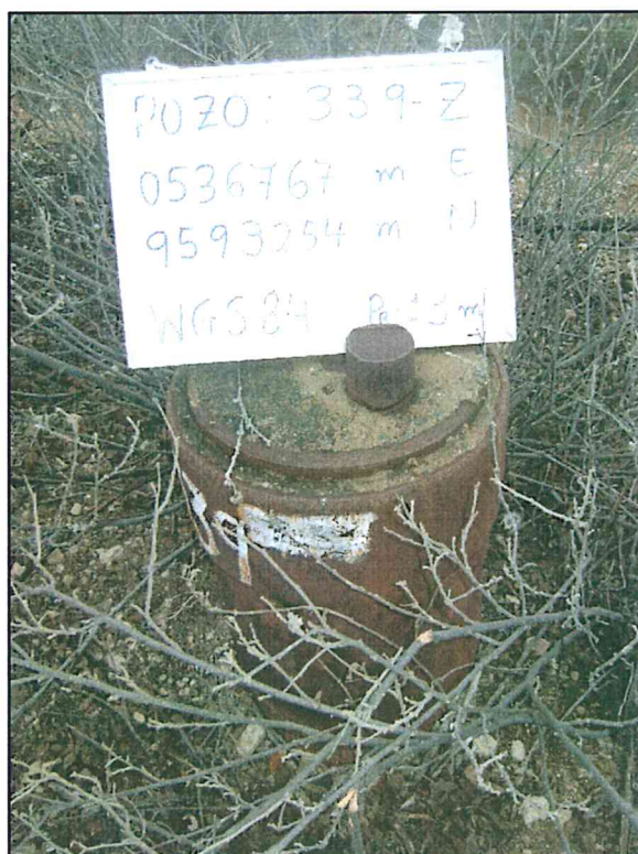
Fotografía N° 1. Se observa que el pozo presenta casing expuesto al ambiente sobre la superficie del suelo.
