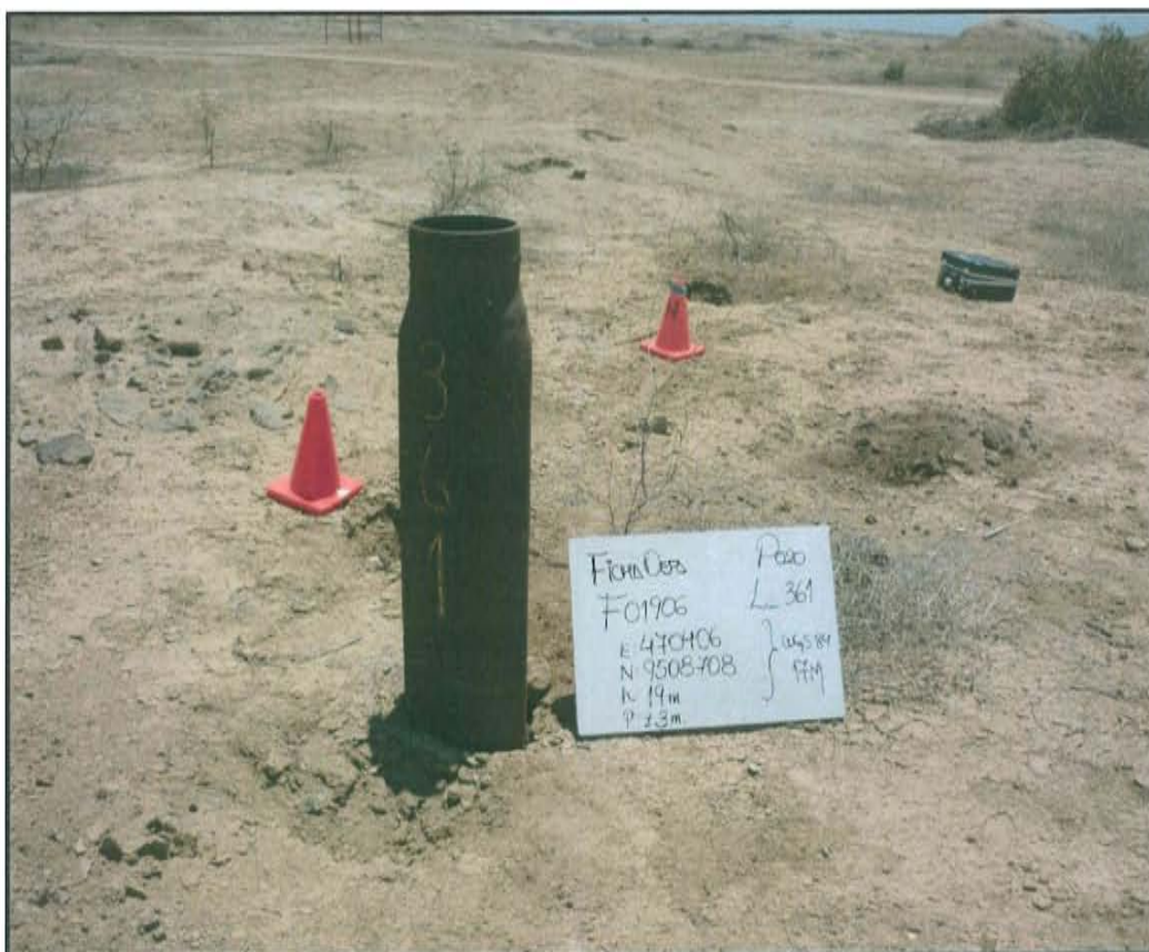
Fotografía N° 1. Casing de 8 plg en estado de corrosión, que emerge de la superficie del suelo a una altura de 1,1 m.
