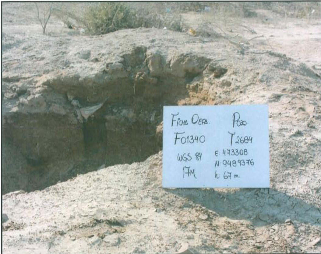
Fotografía N° 1. Pozo T 2684 presenta casing no visible dentro de hoyo de 1,8 m de profundidad.
