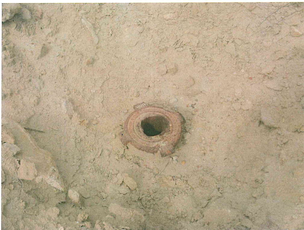
Fotografía N° 1. Pozo A9097 inactivo presenta brida corroída y concéntricamente un orificio de reducción roto de 5 pulgadas de diámetro que se encuentra abierto y sin elementos de cierre que garanticen su hermetismo.
