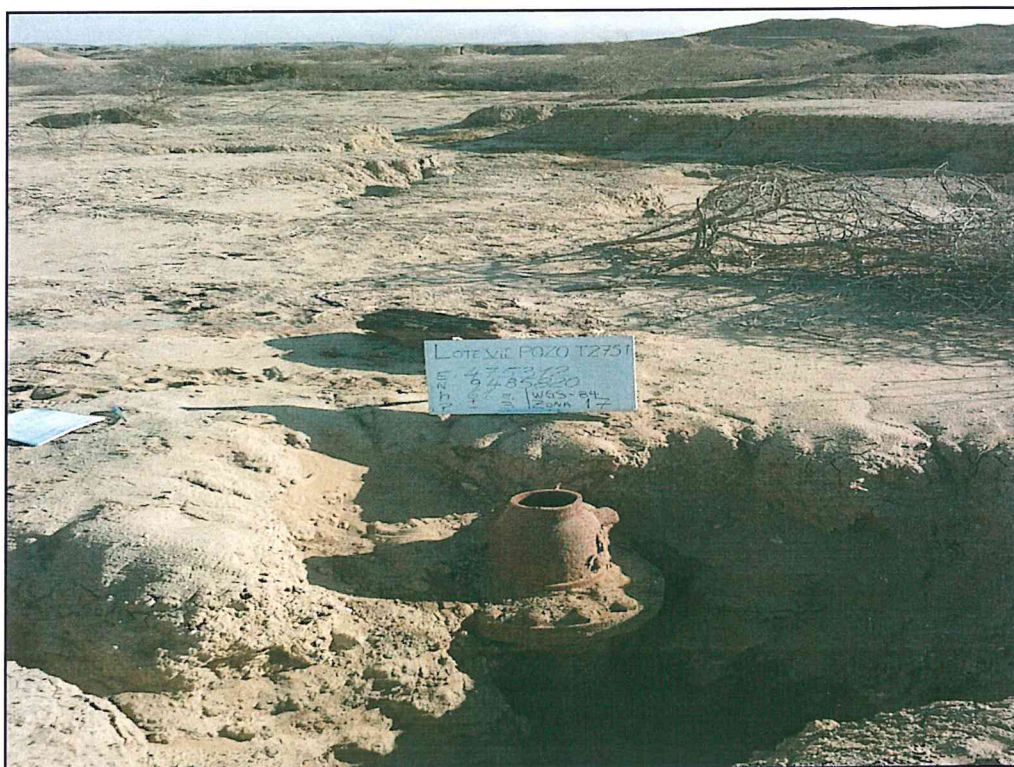
Fotografía N° 2. Vista del Pozo mal abandonado T2751 con Ficha OEFA F00567, se observa casing con brida parcialmente enterrada y tubo de reducción que no sobrepasa el nivel del terreno. Se perciben emisiones gaseosas provenientes del pozo.
