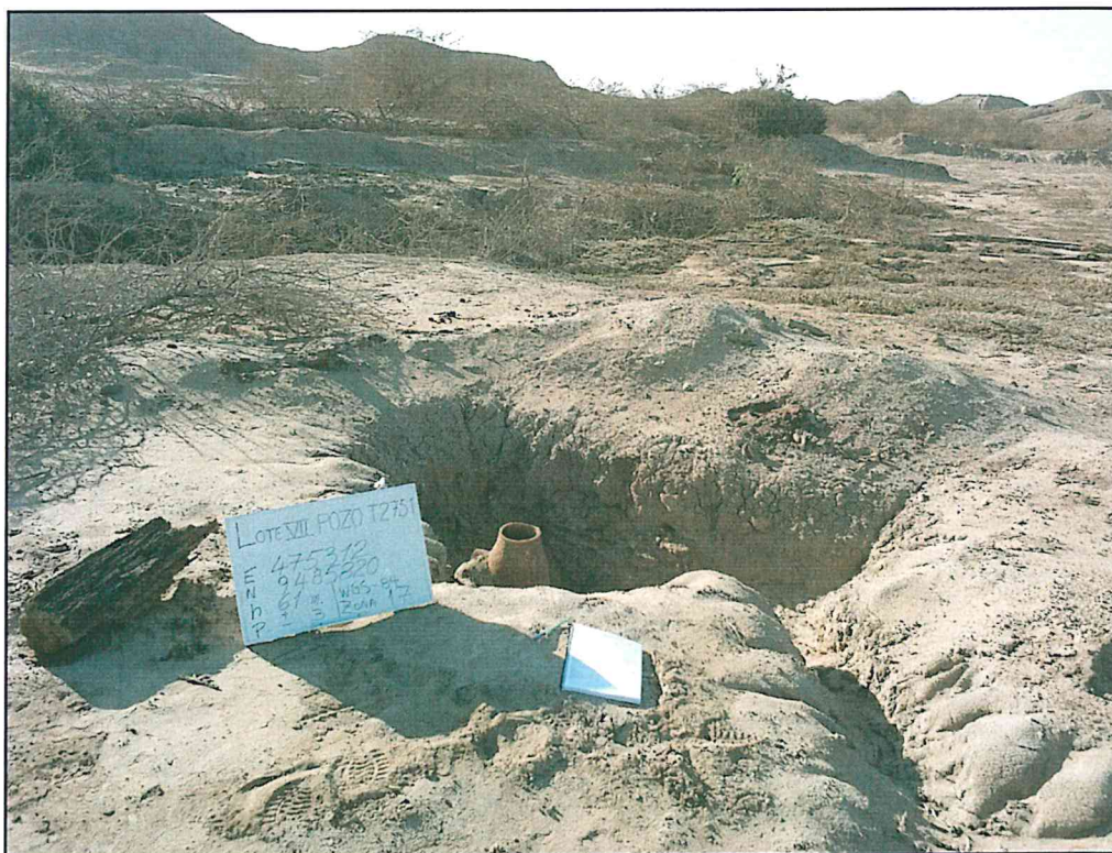
Fotografía N° 1. Pozo inactivo dentro de una excavación de 2m x 1.5m x 1.2m, el casing no sobrepasa el nivel del terreno.
