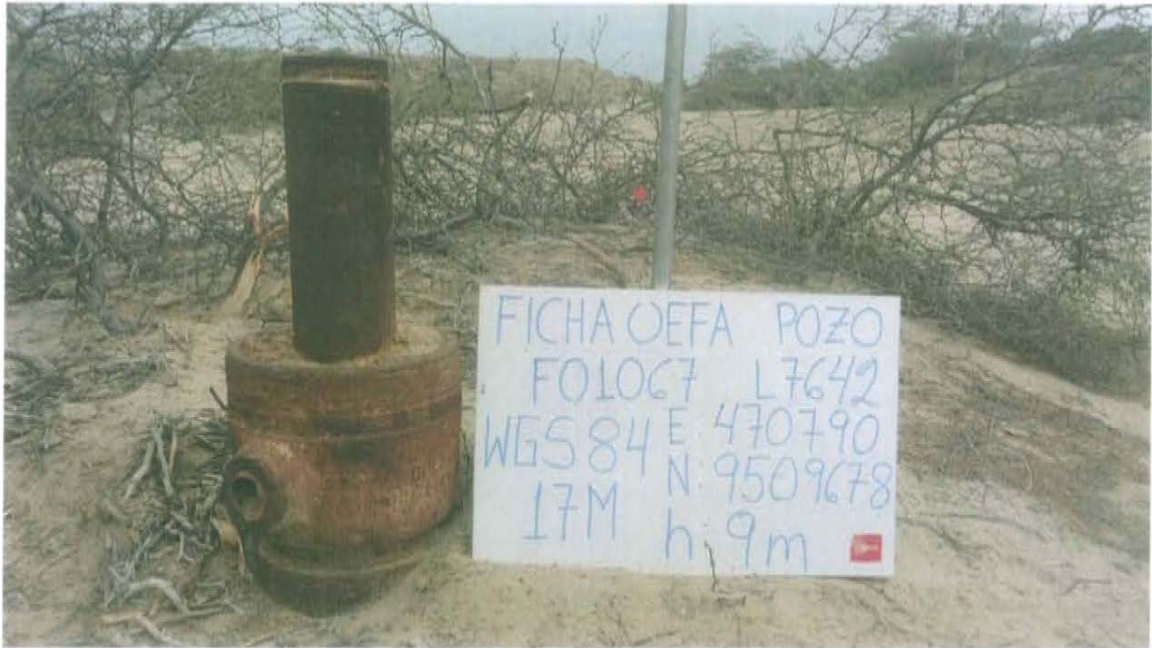
Fotografía N° 1. Pozo L7642, presenta casing de superficie y de producción lleno de tierra.
