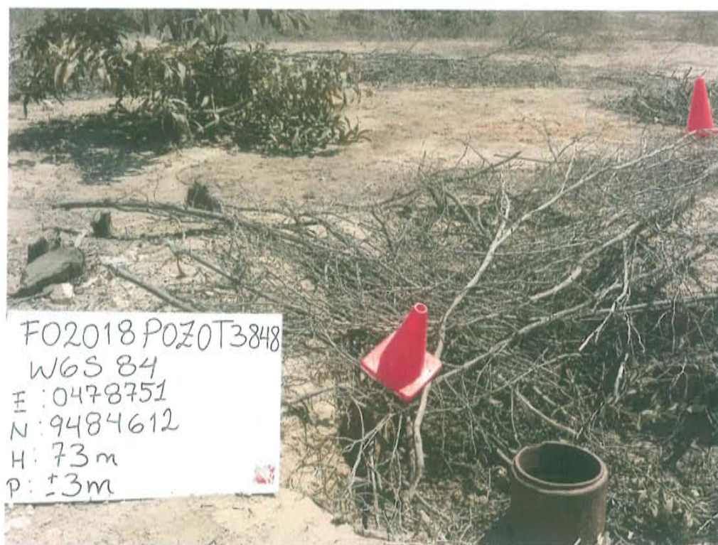
Fotografía N° 1. Pozo T3848, presenta casing de superficie cortado a 0,25 m de altura sobre el nivel del suelo del hoyo, en avanzado estado de corrosión.
