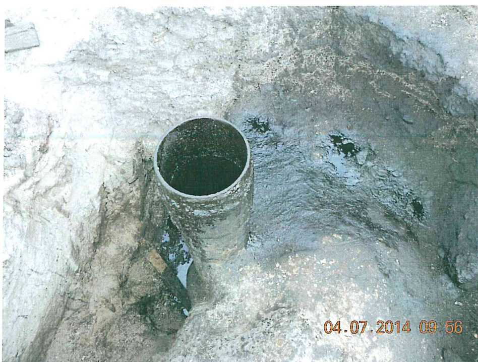
Fotografía N° 2. Pozo abierto al ambiente, cortado en un lado del extremo inferior del casing intermedio e hidrocarburos líquidos expuestos a la intemperie.
