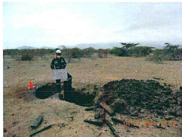
ESTADO DEL POZO EN LA VISITA HECHA POR OEFA
