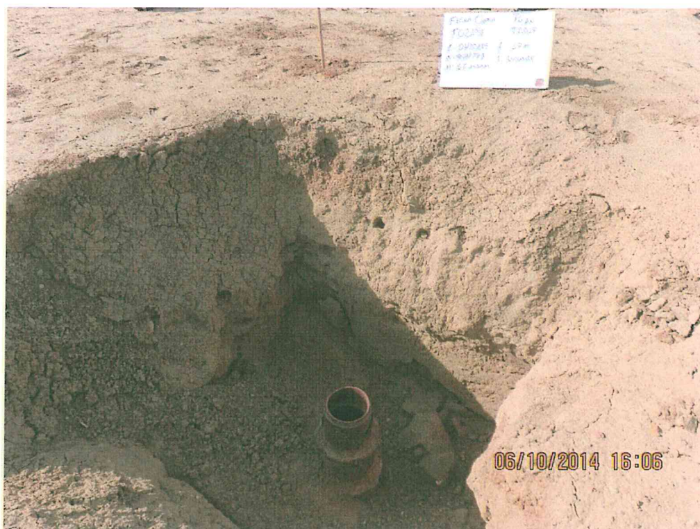
Fotografía N° 1. Vista pozo T2317 ubicado dentro de un hoyo, se observa el casing abierto al ambiente.
