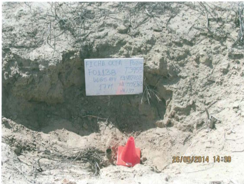
Fotografía N° 1. Pozo inactivo con código PERUPETRO T3955 que se encuentra dentro de un hoyo de aproximadamente 0,98 m de profundidad, el cabezal del pozo se encuentra enterrado solo se observa un tubo de 2 pulgadas que sobresale 0,1 m sobre el nivel del suelo.
