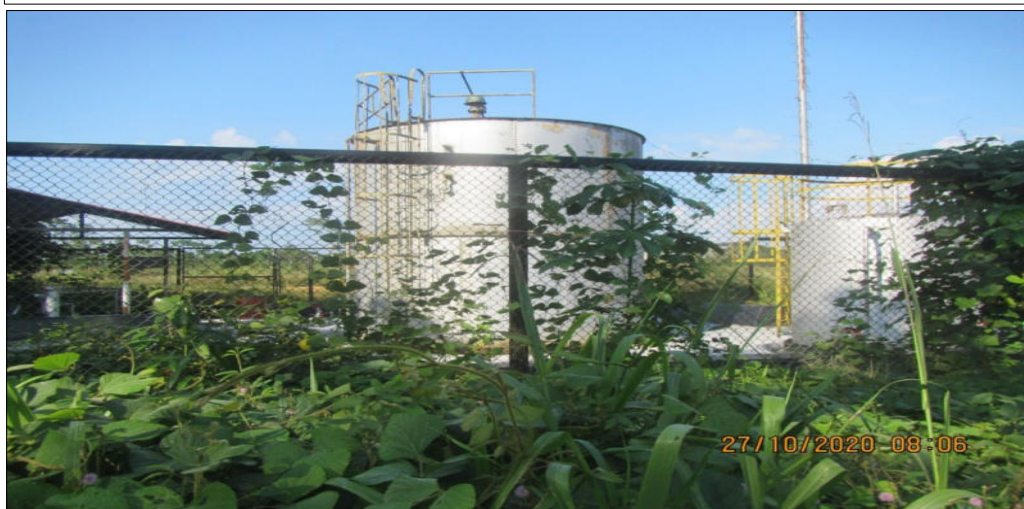
En la fotografía se muestra al Tanque JP-1 y parte de las instalaciones asociadas, el cual almacena el combustible Turbojet que abastece a las aeronaves del aeródromo «Alfárez FAP Vladimir Sara Bauer»
