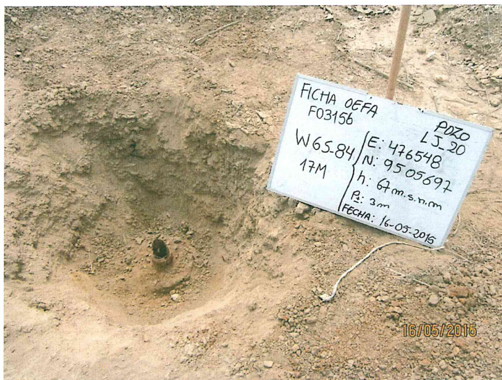
Fotografía N° 1. El Pozo LJ_20 fue ubicado con ayuda del detector de metales a 0,6 m aproximadamente, se observa casing de 9 pulgadas de diámetro con un tubo concéntrico de 2,5 pulgadas cortado y corroído.
