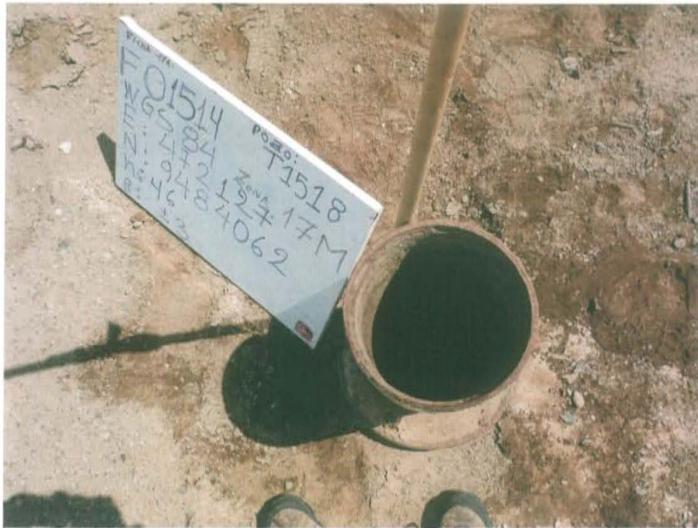
Fotografía N° 1. Identificación del pozo inactivo con código PERUPETRO T1588. Presenta casing abierto al medio ambiente.
