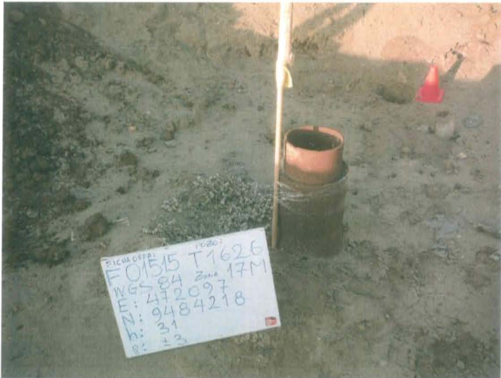
Fotografía N° 1. Identificación del pozo inactivo con código PERUPETRO T1628. Presenta casing abierto al medio ambiente.
