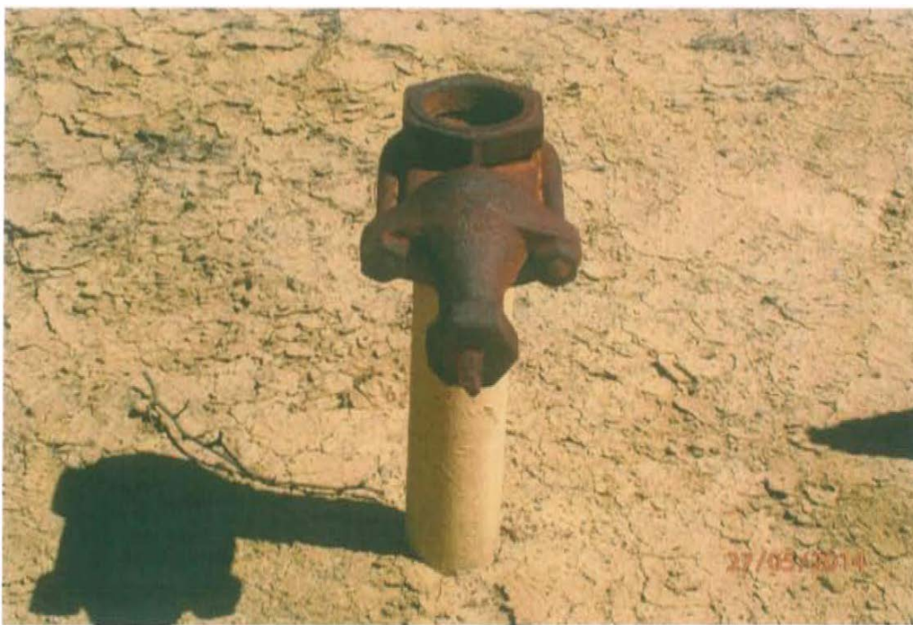
Fotografía N° 1. Vista de ubicación del pozo donde se observa el pozo con el casing y brida en estado de deterioro y abierto.
