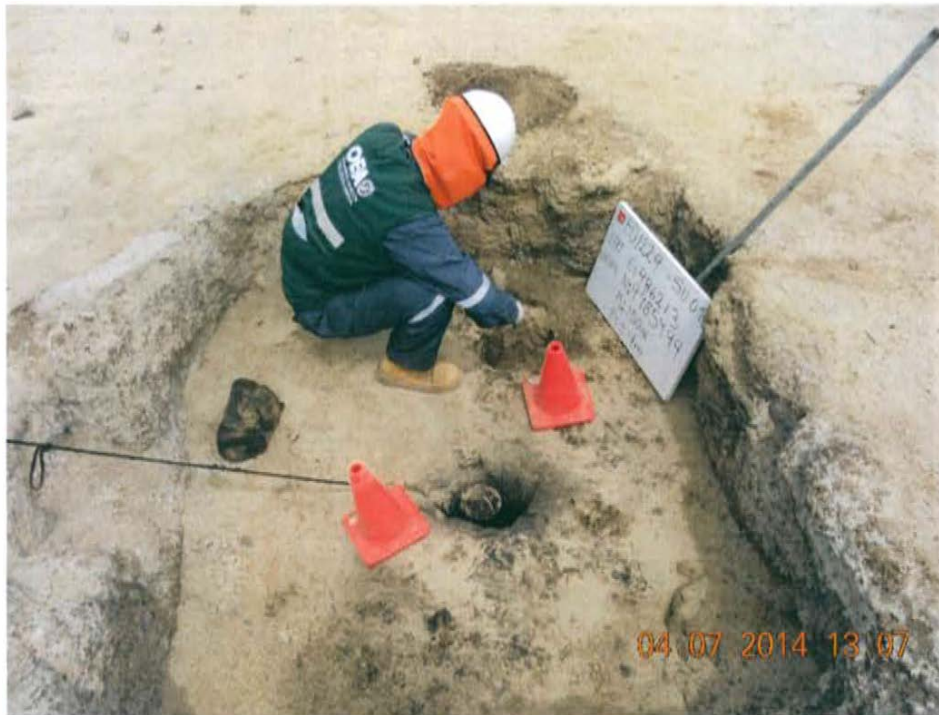
Fotografía N° 3. Se observa casing intermedio corroído de 10 plg de diámetro y casing de producción de 5 plg de diámetro en el interior de un hoyo derruido de sección rectangular de 2,1 m x 1,8 m x 0,6 m de profundidad.
