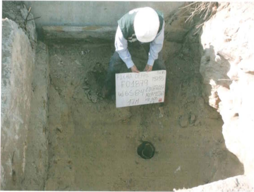
Fotografía N° 1. Pozo inactivo con código PERUPETRO T5755, se encuentra en terreno no habilitado y dentro de cantina deteriorada.
