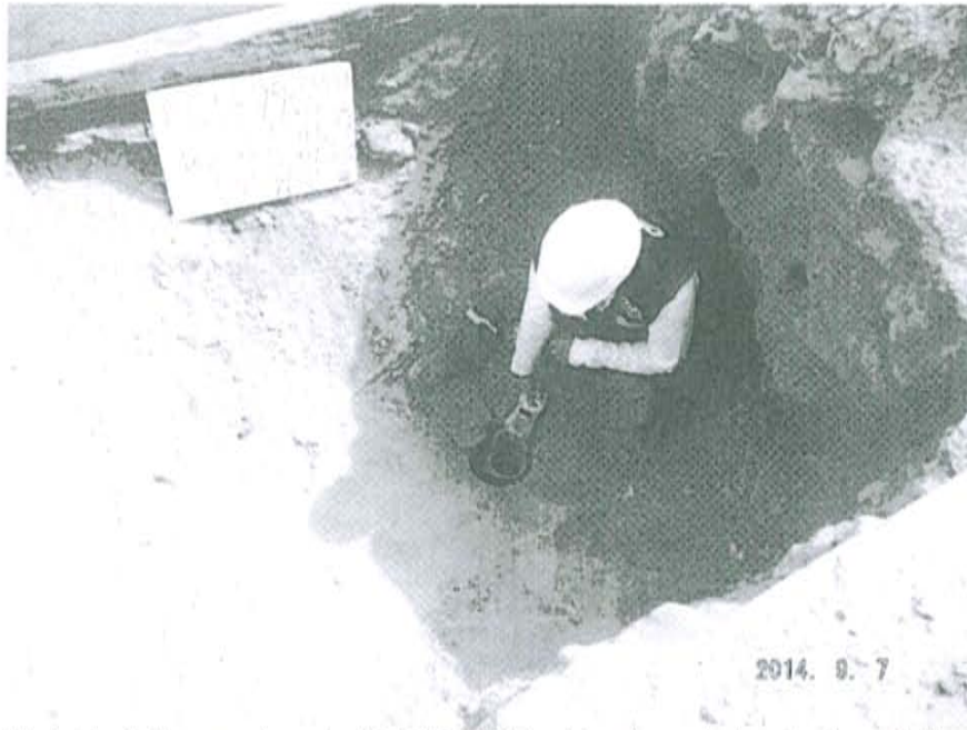
Fotografía N° 1. Medición en el punto F01879-EM01, ubicado en la fuente de emisión en boca del Pozo T5755.
