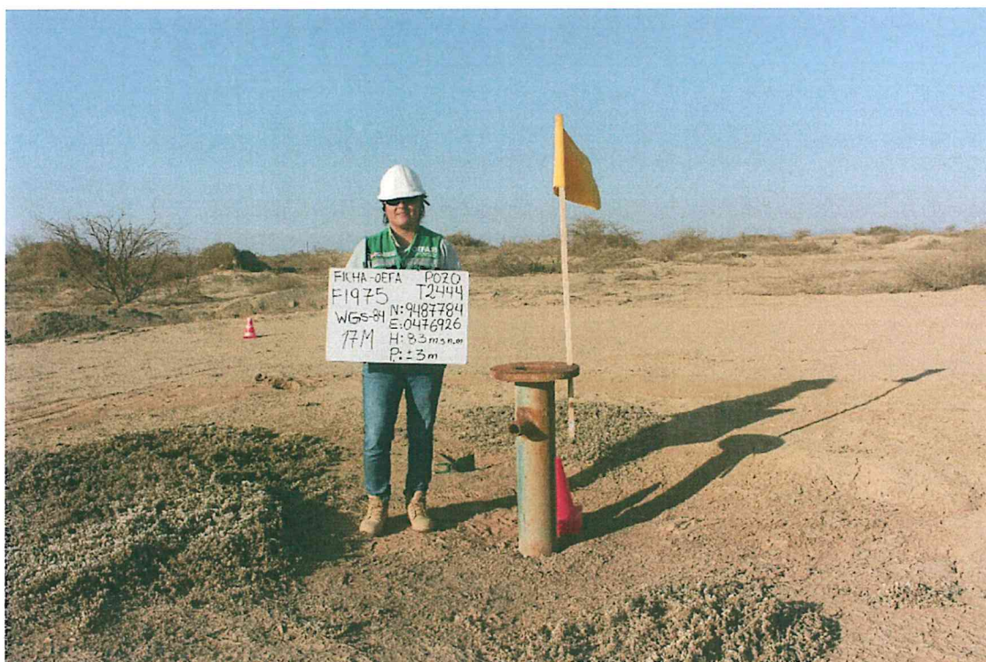
Fotografía N° 1. El Pozo T2444 presenta una brida unida al casing con una salida lateral, los cuales se encuentran abiertos y expuestos al ambiente.
