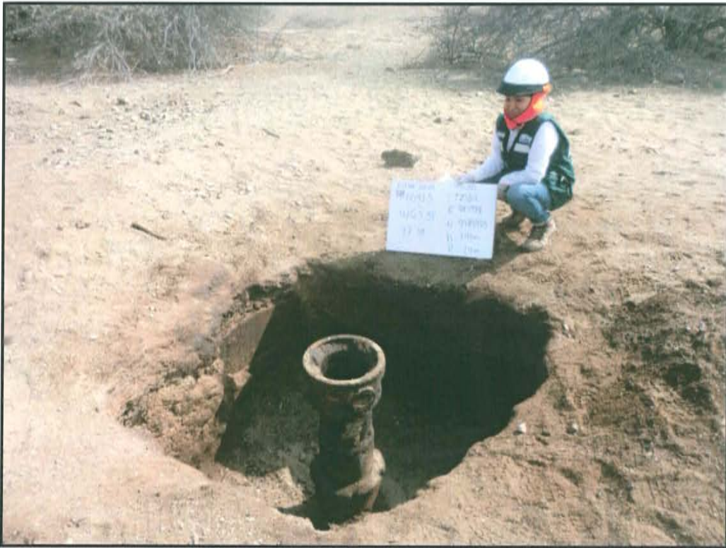
Fotografía N° 1. Pozo T2334 presenta casing de 12 plg que sobresale a una altura de 0,8 m desde la base del hoyo de 0,7 m de profundidad.
