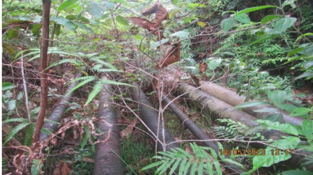
Troncal de 6 ductos (dos de 10", dos de 8", uno de 4" y uno de 2" de diámetro) que se encuentran sobre marcos H. Estos ductos están asociados al transporte de hidrocarburos desde las Plataformas B y P hacia la Bateria Capahuari Sur.
