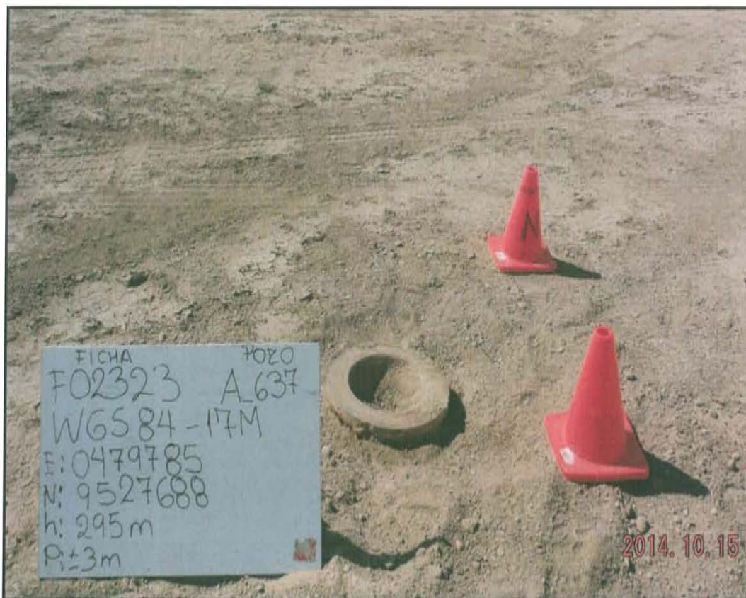
Fotografía N° 1. Pozo A_637 no posee cabezal, se aprecia brida de 14 plg que se encuentra unida al casing enterrado de 10 plg.
