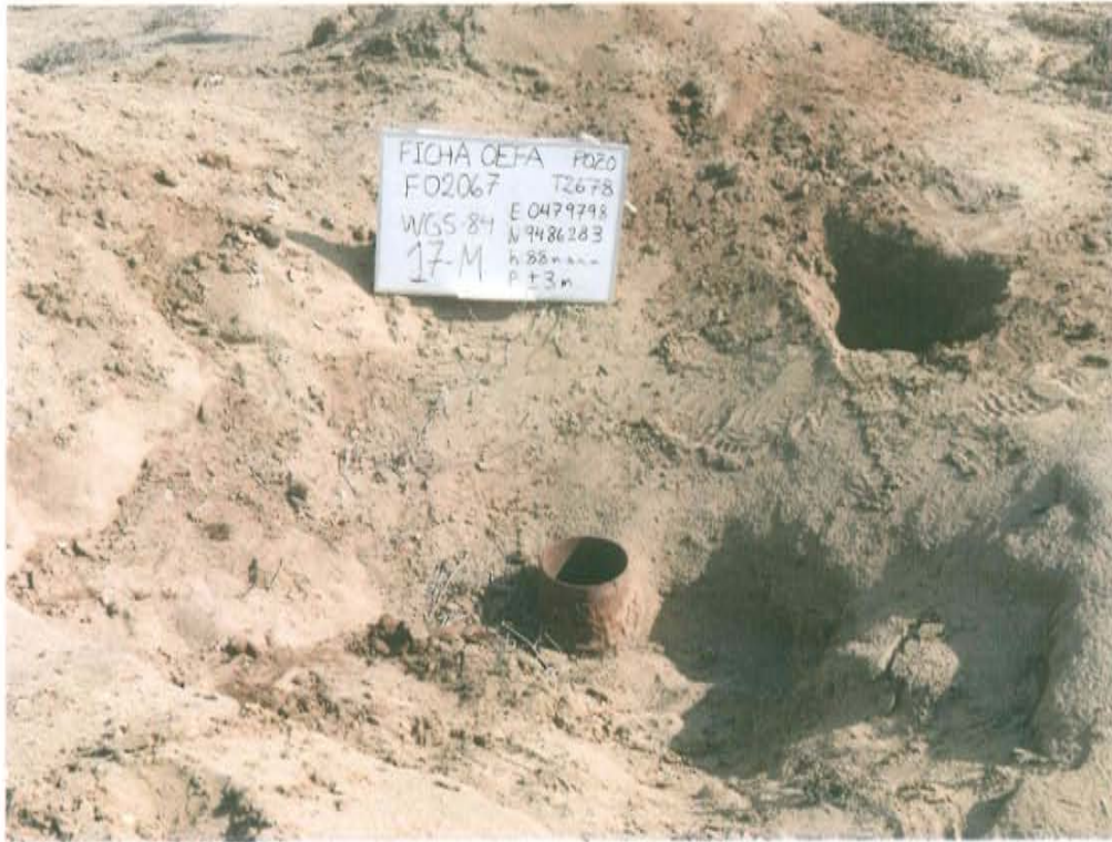
Fotografía N° 1. Pozo con código PERUPETRO T2678 inactivo mal abandonado sobresale una altura de 0,18 m sobre el nivel de la superficie del suelo.
