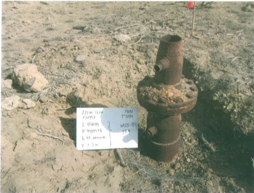
Fotografía N° 1. Se observa que el Pozo T3284 presenta cabezal compuesto por una brida unida a un casing de 6,5 pulgadas y a un tubo de reducción con salidas laterales abiertos y expuestos al ambiente.
