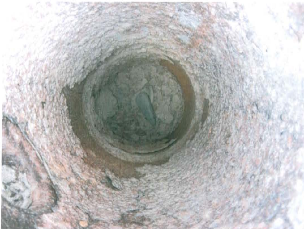
Fotografía N° 2. Se observa al interior del Pozo T3284, lleno de arena y piedras; sin embargo esto no garantiza su hermetismo.
