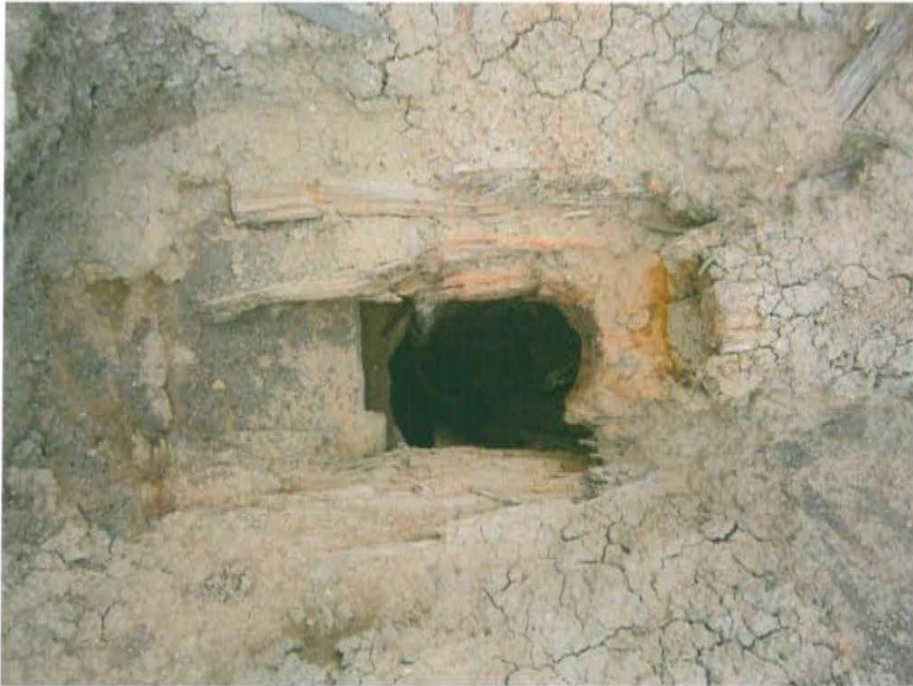
Fotografía N° 2. Se observa pozo inactivo que presenta casing abierto, sin elemento de cierre tales como válvulas, llaves entre otros, que garanticen un cierre hermético del pozo.
