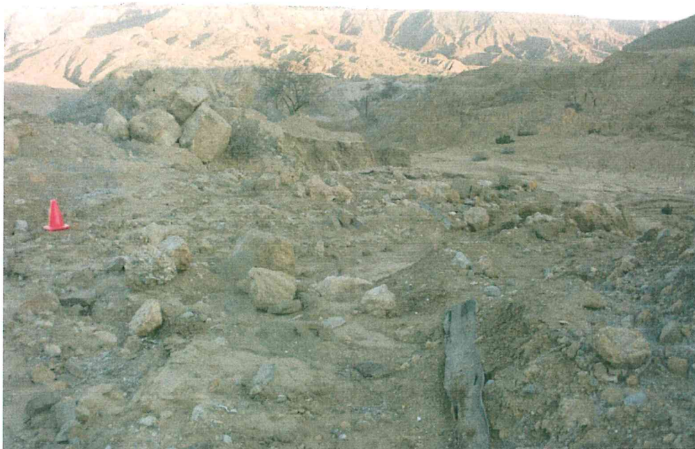
Fotografía N° 3. Vista del material que ha quedado sobre el terraplén y ha Destruído parte de la vía de acceso vehicular.
