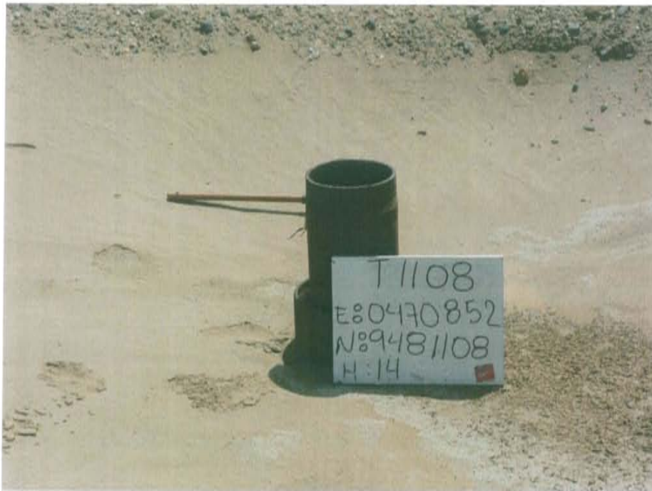
Fotografía N° 2. Se observa pozo inactivo que presenta una casing y tubing que se encuentra abierto, sin elemento de cierre en superficie tales como válvulas, llaves entre otros que garanticen un cierre hermético del pozo.
