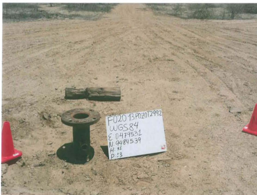
Fotografía N° 1. Pozo T2992, con casing corroído, a 0,4 m de altura sobre el nivel del suelo y 14,9 plg de diámetro, con brida pero sin accesorios que aseguren su hermetismo.
