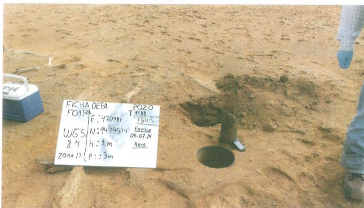
Fotografía N° 1. Ubicación del pozo con casing al nivel del suelo, corroído y relleno de suelo debido a los vientos fuerte en esta zona.
