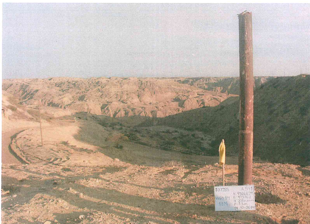
Fotografía N° 1. Pozo A_541 con tubería de revestimiento que sobresale 3,5 m. sobre la superficie del suelo no presenta cabezal por lo que se encuentra abierto al ambiente.
