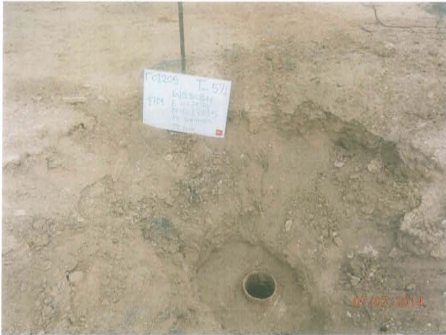
Fotografía N° 1. Pozo T_591, presenta casing corroído y abierto, con fluido en su interior.
