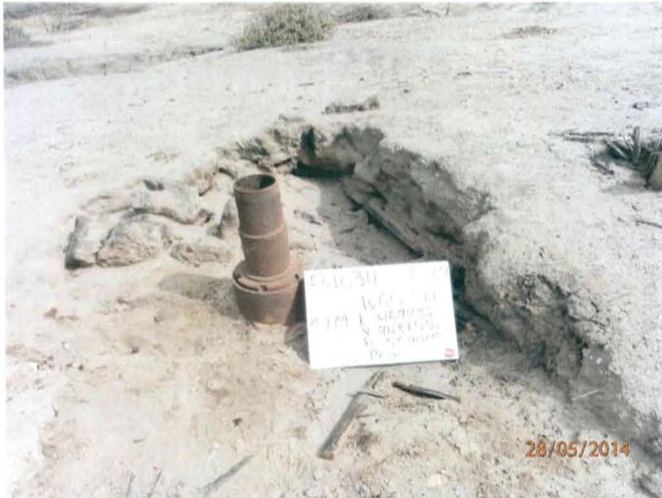
Fotografía N° 3. Casing corroído de 12 plg de diámetro, abierto al ambiente, sin accesorios que aseguren su hermetismo, ubicado dentro de un hoyo destruido.
