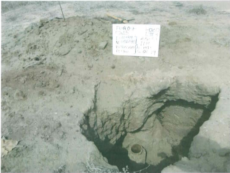
Fotografía N° 1. El Pozo T2113 se ubica en un hoyo de sección cuadrada, donde se observa el casing sin cabezal ni válvulas que aseguren su hermetismo.
