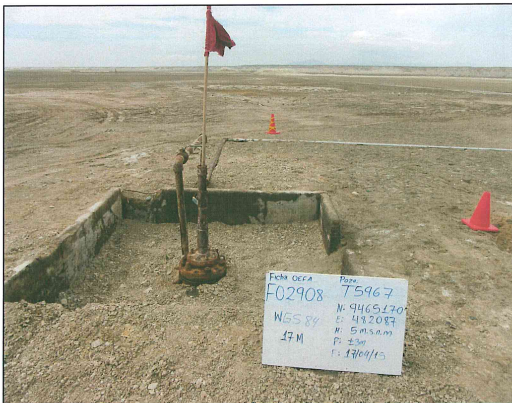
Fotografía N° 1. Cabezal de pozo con código PERUPETRO T5967 compuesto por válvulas, tuberías y bridas, que emerge a una altura de 1 m desde la base de la cantina de 0,4 m de profundidad.
