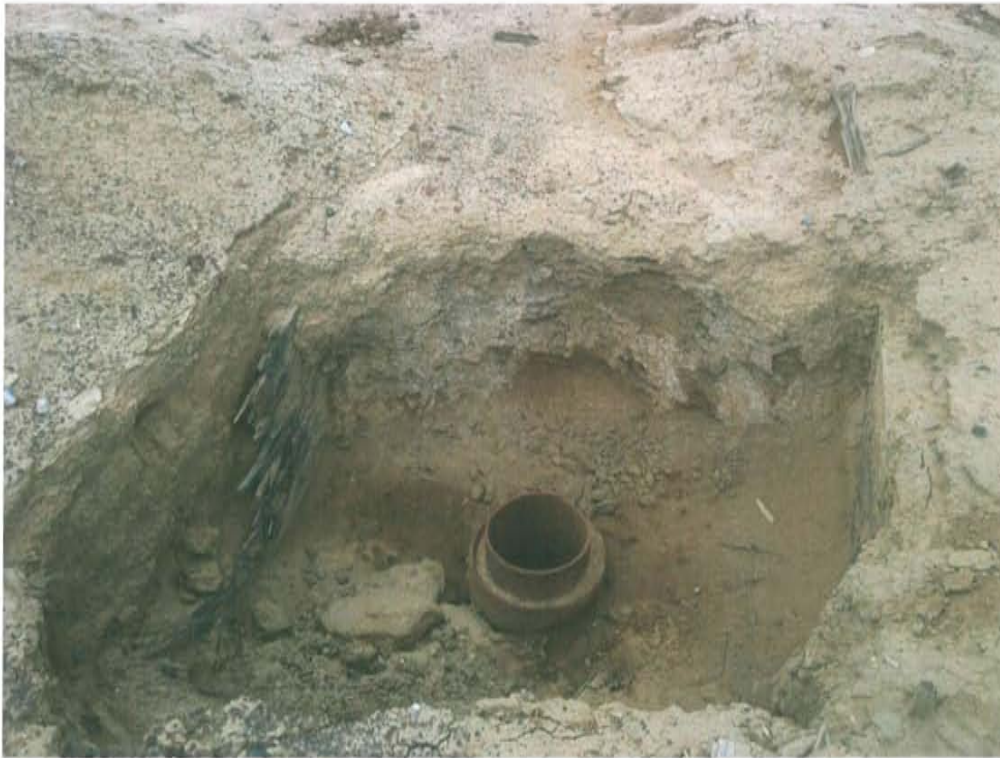
Fotografía N° 1. Pozo con código PETRUPETRO T2096 inactivo mal abandonado, dentro de una cantina destruida se encuentra el casing cuyo cabezal ha sido cortado.
