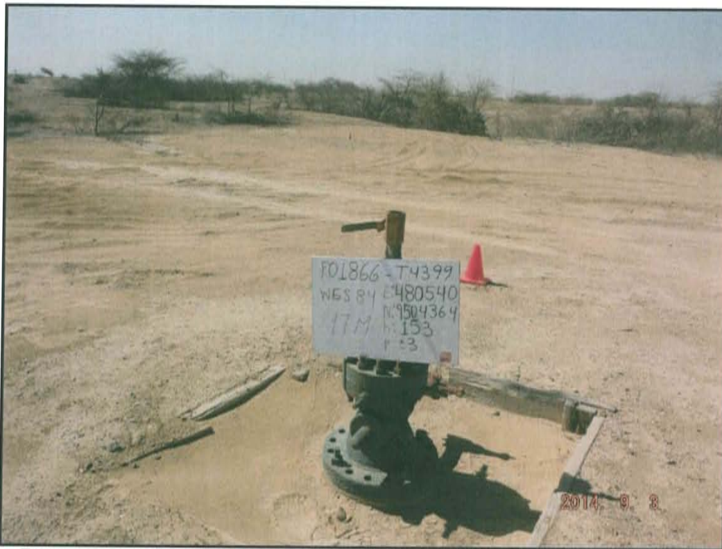
Fotografía N° 1. Pozo inactivo con cabezal compuesto por bridas y válvulas que se encuentra dentro de hoyo revestido de madera relleno con tierra.
