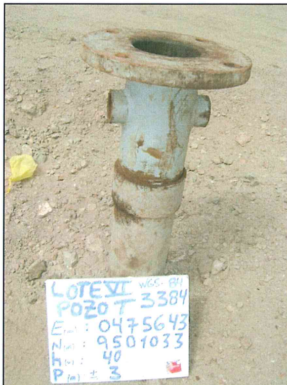
Fotografía N° 1.- Ubicación del Pozo T3384, se observa casing con brida abierto al ambiente.
