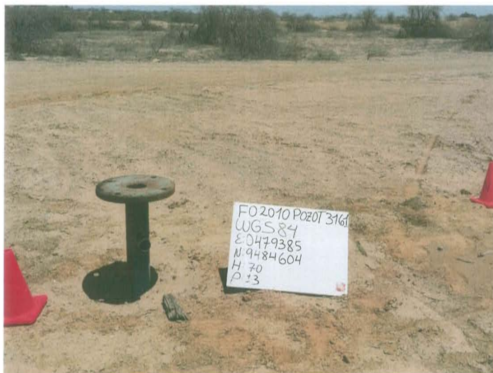
Fotografía N° 1. Pozo T3161, presenta casing con brida sin accesorios que aseguren su hermetismo por lo que se considera comoun pozo abierto y expuesto en la superficie.
