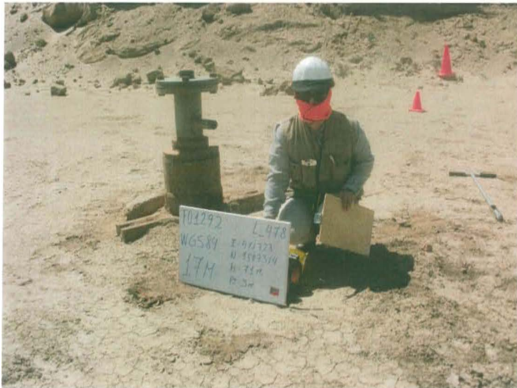
Fotografía N° 2. Pozo L_478 presenta tubería superior y lateral abierta sin elementos de cierre que garanticen su hermetismo.
