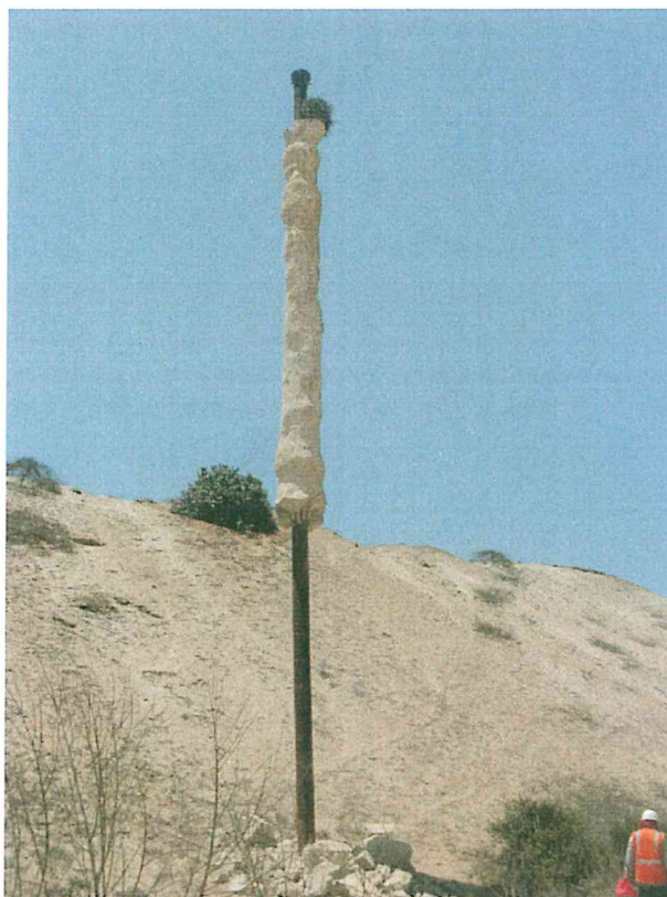
Fotografía N° 1. El casing del Pozo A6524 emerge 32 m aproximadamente desde la superficie del suelo encontrándose expuesto al ambiente.
