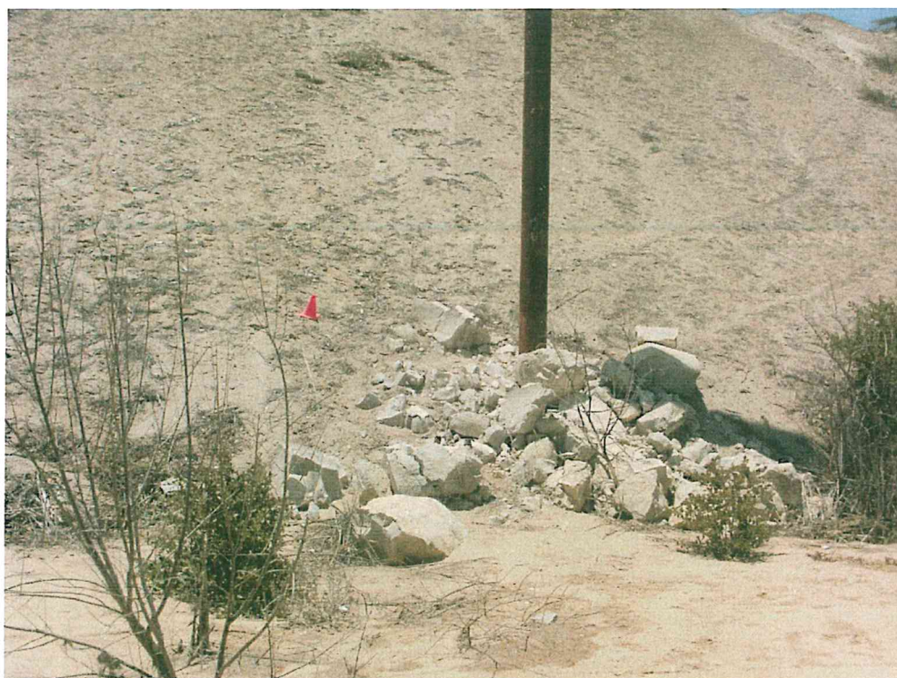
Fotografía N° 2. Se observa restos de concreto que se han ido desprendiendo del casing.
