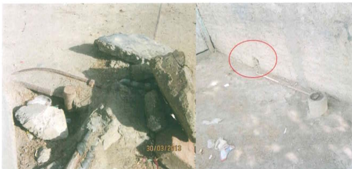
Fotografía N° 2. Se observa las conexiones de tuberías expuestas al ambiente, que son direccionadas a las viviendas aledañas.
