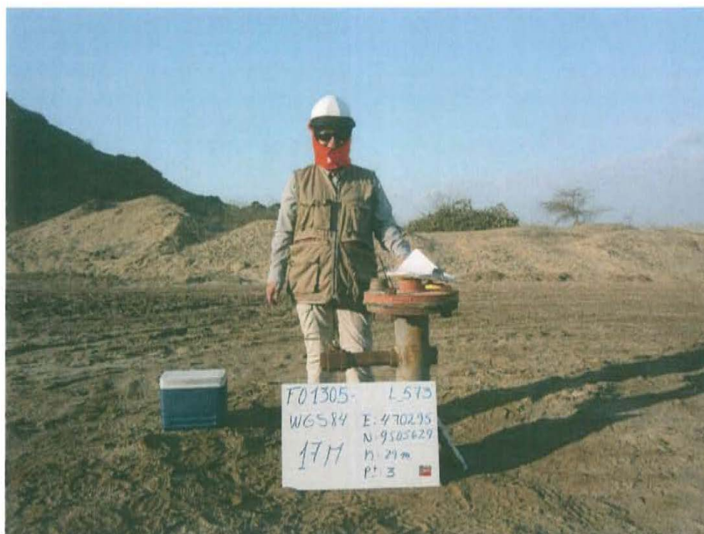
Fotografía N° 1. Se observa Pozo L_573 con válvula de reducción abierta y expuesta al ambiente.
