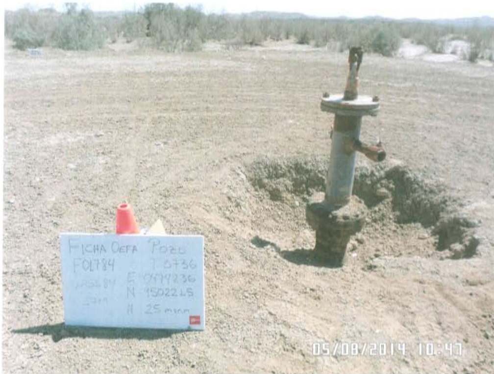
Fotografía N° 1. Identificación del pozo inactivo con código PERUPETRO T3736. Presenta casing con bridas y válvulas.
