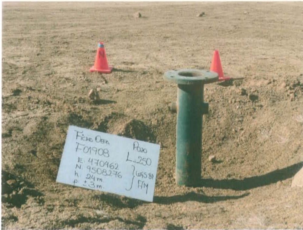
Fotografía N° 1. Identificación del pozo inactivo con código PERUPETRO L_250. Presenta casing con brida abierto al medio ambiente.
