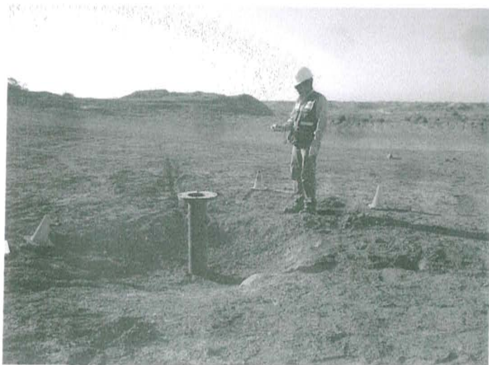
Fotografía N° 2. Mediciones en el punto F01908-VA01, se realizó en un recorrido en el área circundante alrededor del Pozo L_250 en un radio de 1 m.
