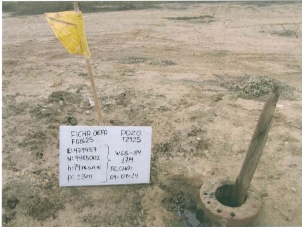
Fotografía N° 1. El Pozo T2925 presenta casing de aproximadamente 8 pulgadas con cabezal compuesto por una brida, pero sin válvulas que aseguren su hermetismo.
