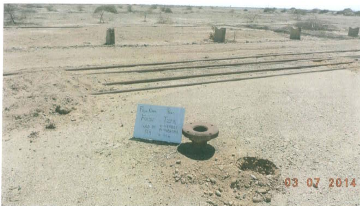
Fotografía N° 2. Se observa pozo abierto y expuesto al ambiente que no se encuentra herméticamente cerrado, con tubería de revestimiento y brida corroídos.
