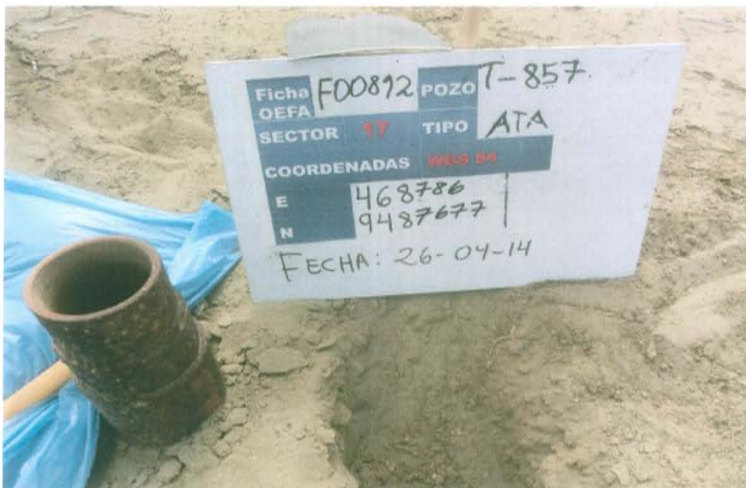
Fotografía N° 1. Vista de la ubicación georeferencial donde se observa el relieve donde se encuentra el pozo con el casing abierto en estado de deterioro.
