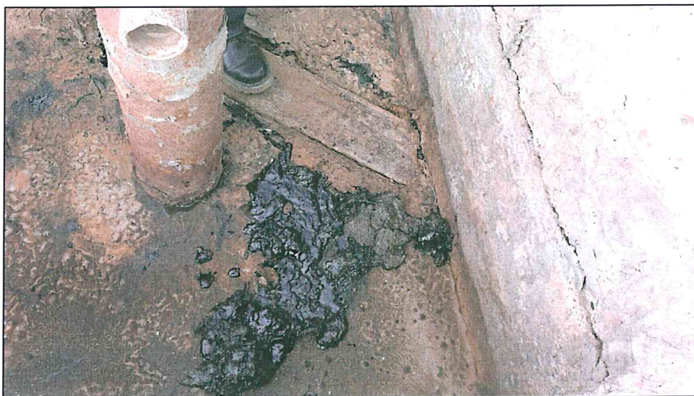
Fotografía N° 3. Se observa el Pozo T3587 con casing abierto, tubo de producción con presencia de posible hidrocarburos líquidos en su interior.
