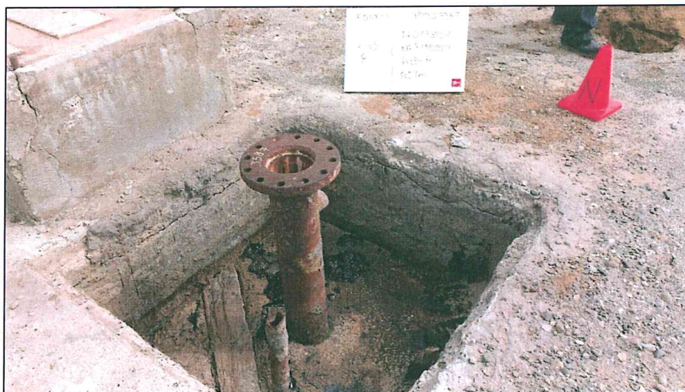
Fotografía N° 1. Se observa el Pozo T3587 con casing con cabezal incompleto y sin válvulas que aseguren su hermetismo.
