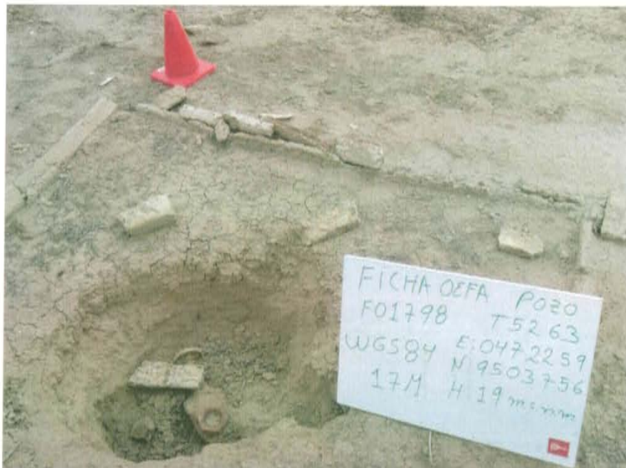
Fotografía N° 2. Se puede apreciar el casing corroído, con una válvula a nivel de superficie de suelo.
